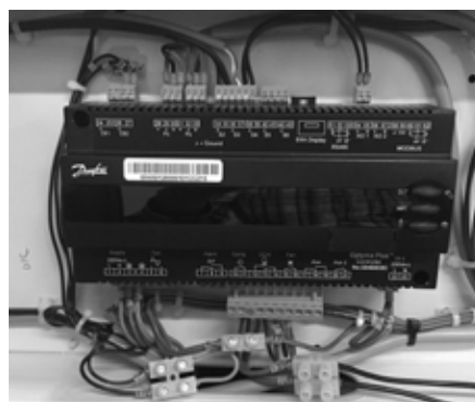
Bilde 4: Midlertidig kabling
