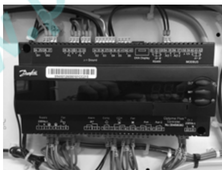
Billede 3: Normal ledningsføring
