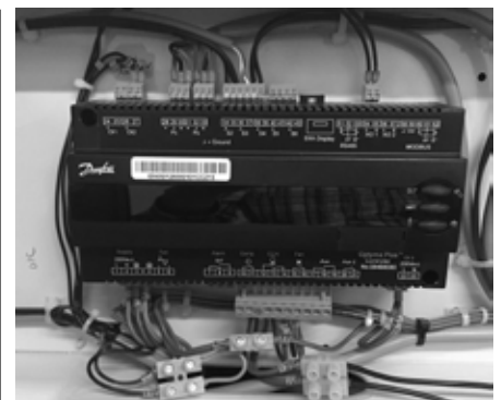
Bild 4: Vorläufige Verdrahtung für Notbetrieb
