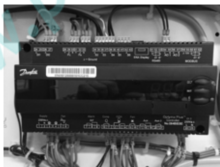
Bilde 3: Normal kabling
